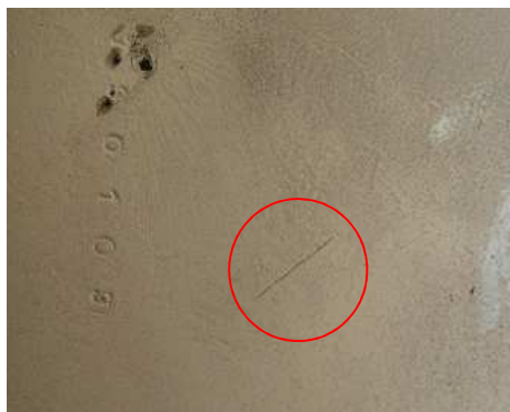
Defecto encontrado tras el ensayo realizado
